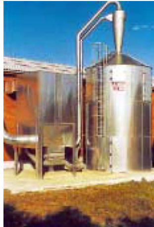
Silo 73 m 3 zur Entleerung eines Saugwagens
