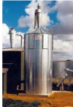
Silo 96 m 3 für Heizungsanlage und Entleerung eines Saugwagens
